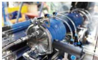
공정 후 배출되는 배관에 냉각 장치를 설치하여 챔버(Chamber) 통과 후 발생하는 열로 인한 시료의 손상 방지
